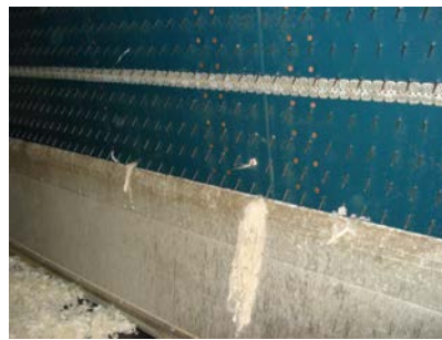
Detalle de la parte posterior de la telera, donde se observa el empalme con grapas.
